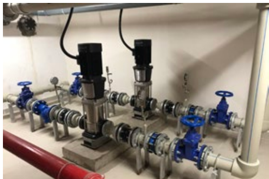
Hệ thống bơm bù áp /Booster pumps
