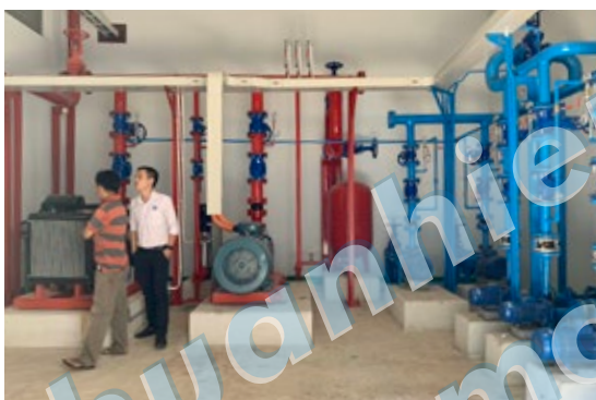
Phòng bơm sau khi lắp đặt hoàn chỉnh Pump room after installation is complete
